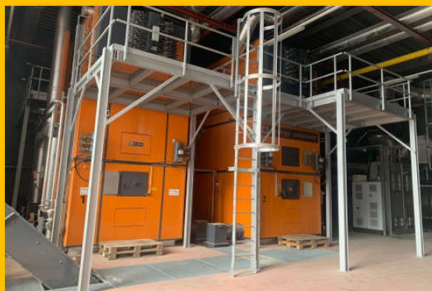
Les deux chaudières à bois, de 3.2 kW de
